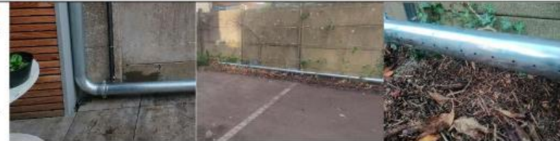
Dévoisement de la gouttière
